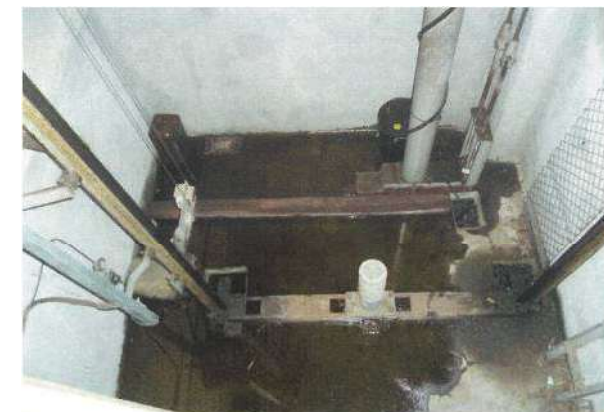
工場棟昇降機オイル漏れ状況↓
