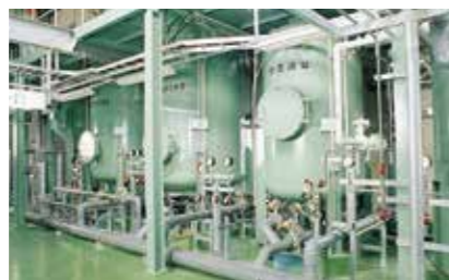
高度処理設備
