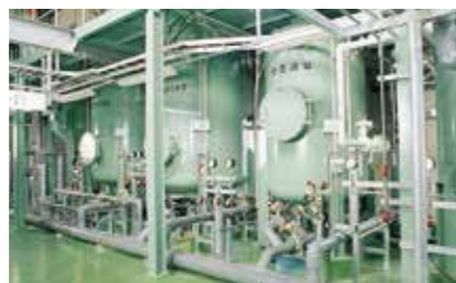
高度処理設備
